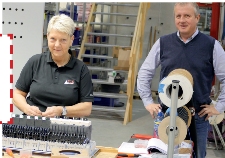
Rita Laland i full gang med bygging av tavler, som skal monteres i styreskap.
